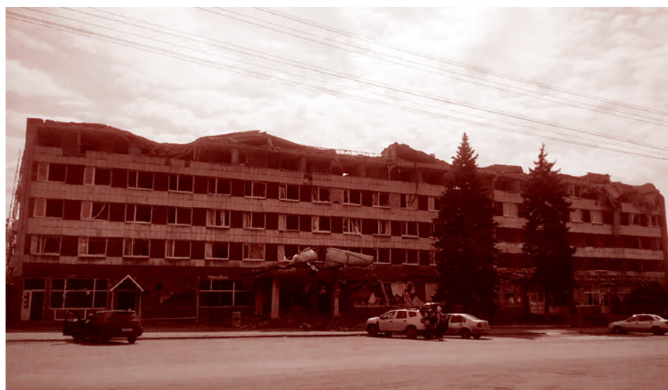
Разрушенное здание в Луганске
